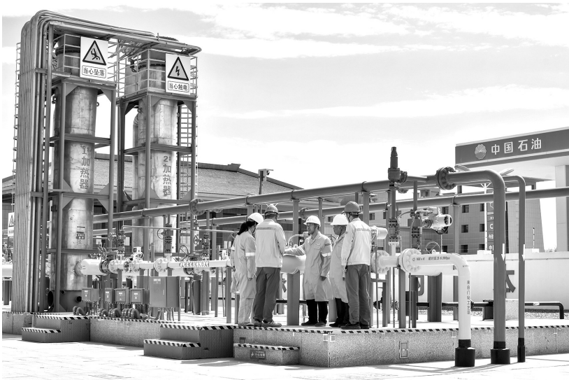
多部门联合检查分站燃气管道。
